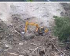
遠隔操縦式油圧ショベル
