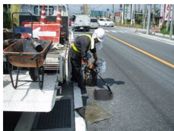
〈路面補修〉 (ポットホール)
