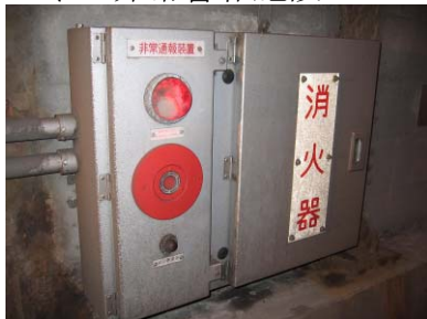
〈三国トンネル非常警報施設〉 (国道17号 みなかみ町永井)
