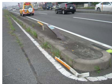
〈道路附属物損傷確認〉
