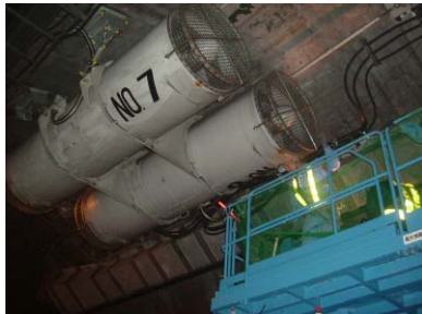
〈三国トンネルジェットファン〉 (国道17号 みなかみ町永井)
