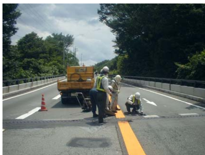
〈路面段差確認〉
