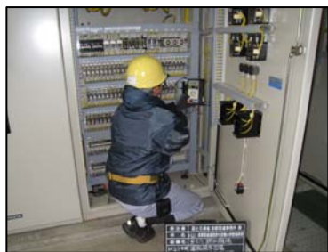
〈排水設備（電源装置点検）〉
