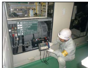
〈発電設備（蓄電池等点検）〉
