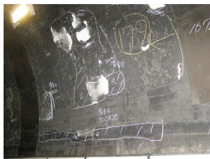
【トンネル損傷】
