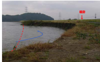
洪水流により堤防直近の河岸が洗掘 (平成16年洪水 栃木県真岡市)
