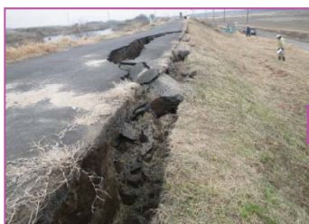
地震発生後の点検により、堤防にクラックを発見。
