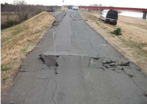
被災状況(平成23年3月11日撮影)
