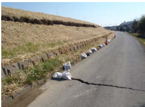
被災状況(平成23年3月13日撮影)
