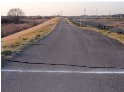
被災状況(平成23年3月13日撮影)
