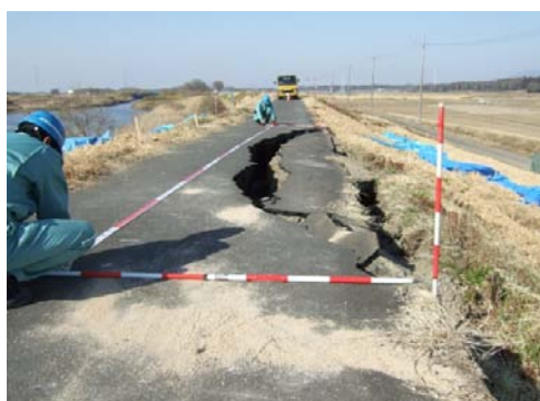
被災状況(平成23年3月13日撮影)
