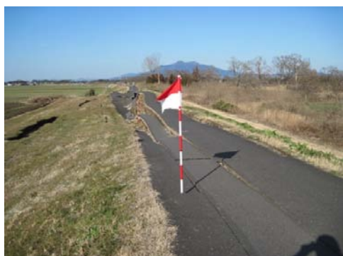
被災状況(平成23年3月12日撮影)
