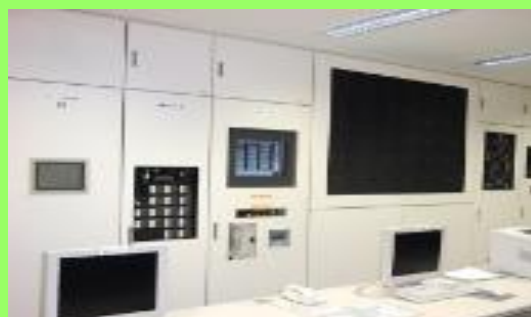
中央監視装置
