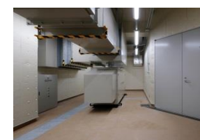
3階 自家発電機室
