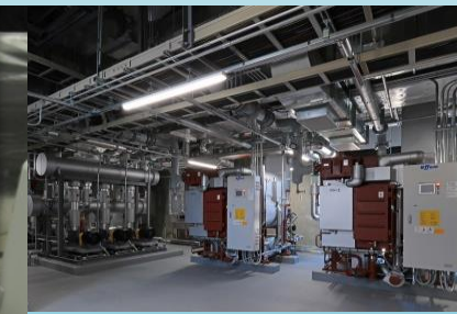
空調のための熱源機器
