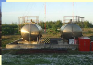
発電機用オイルタンク
