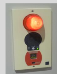
非常警報装置
