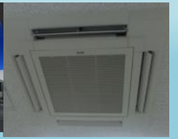
天井部の空調機
