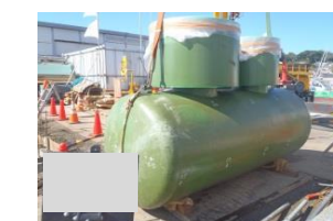
地下オイルタンク
