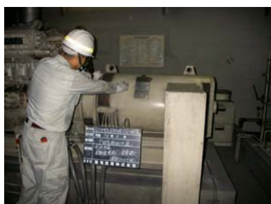
〈発電設備 定期点検状況〉
