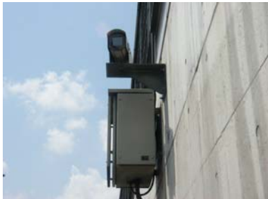
〈小淵立体 CCTV カメラ〉 （国道 1 6 号 春日部市小淵地先）
