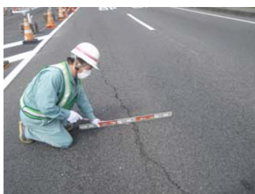
〈路面状況確認（わだち発生）〉
