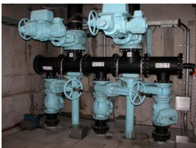
〈小淵立体道路排水設備〉 （国道 1 6 号 春日部市小淵地先）
