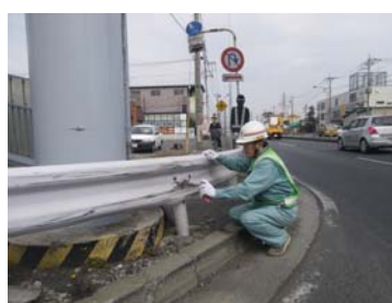
〈構造物の状況確認（防護柵損傷）〉
