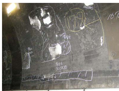
【トンネル損傷】
