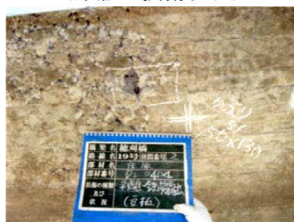
(床版の損傷状況)
