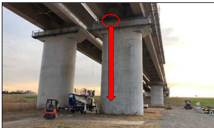
橋梁の下部工検査路設置作業中、作業員1名が転落し死亡が確認された事案
