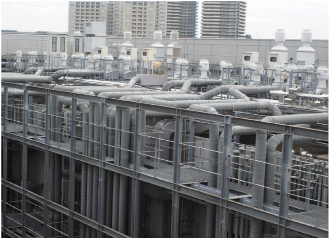
本館実験棟屋上排ガス処理装置（スクラバー）
