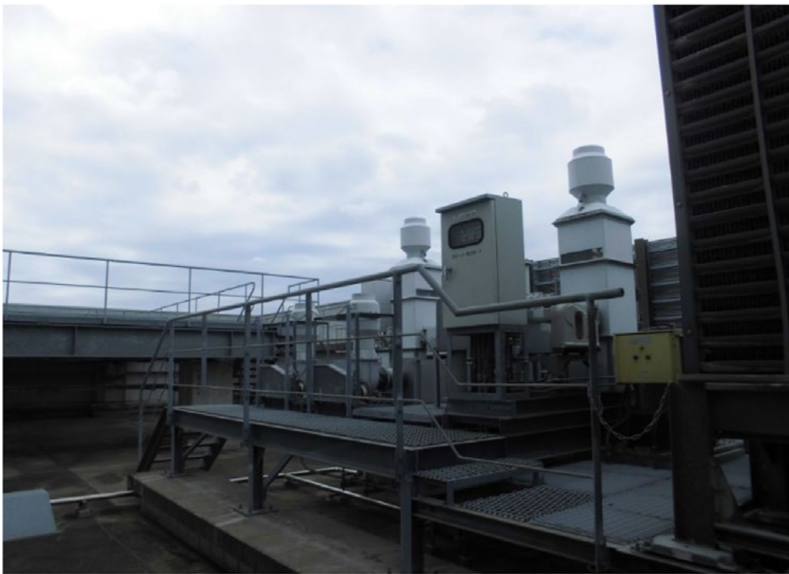
本館事務棟屋上排ガス処理装置（スクラバー）
