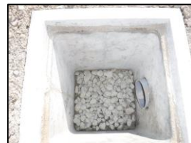
雨水貯留浸透枡整備事例（昭和町）
