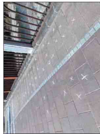
【橋面タイルの浮き】
