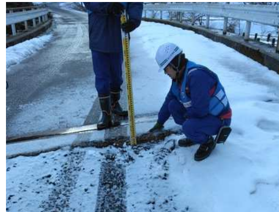
(能登町内での被災状況調査)
