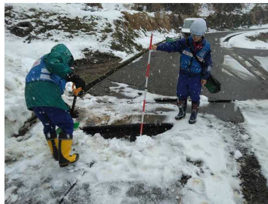
(能登町内での被災状況調査)
