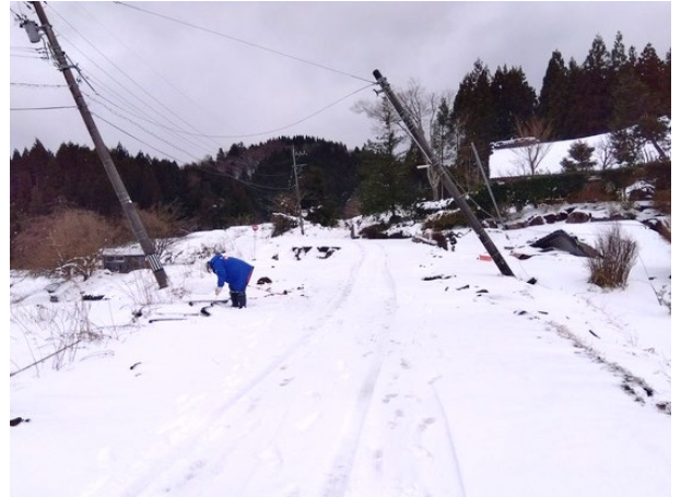
被災状況調査（傾斜した電柱）【1月25日】
