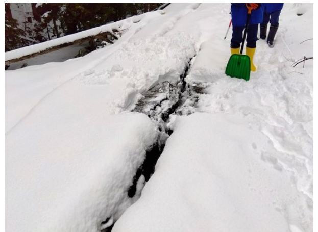
被災状況調査（亀裂の入った路面）【1月26日】
