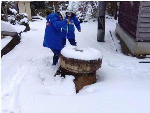
被災状況調査（液状化現象により隆起したマンホール）【1月25日】
