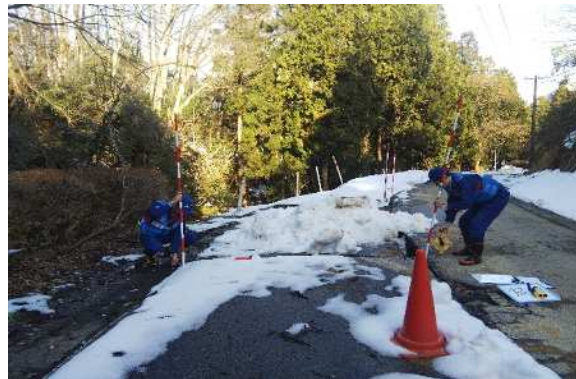
(能登町内での被災状況調査)
