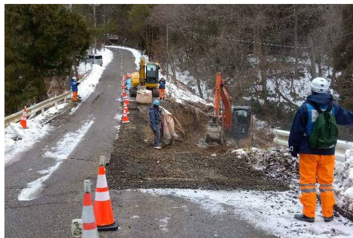
(能登町内での被災状況調査)
