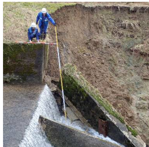
(輪島市内での被災状況調査)
