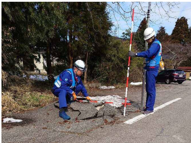
(能登町内での被災状況調査)
