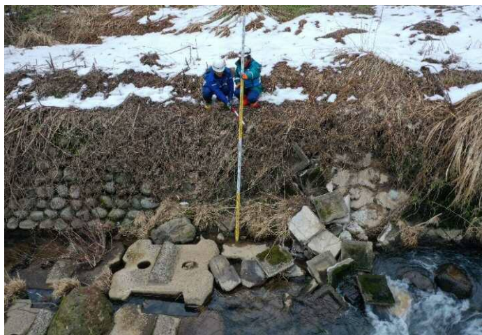
(輪島市内の阿岸川での被災状況調査)
