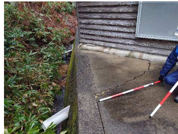
(輪島市内での被災状況調査)
