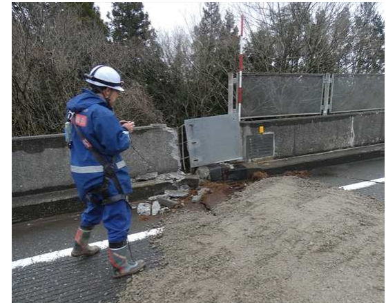
(穴水町での被災状況調査)
