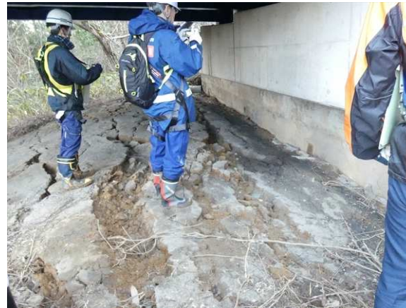
(七尾市での被災状況調査)
