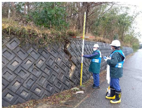
(志賀町内での被災状況調査)
