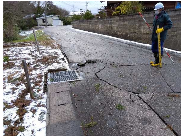
(志賀町内の被災状況調査)
