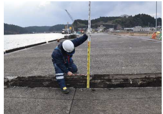
被災状況調査(港湾)
