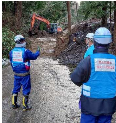
被災状況調査班(砂防)
