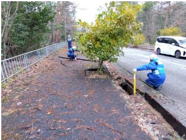
被災状況調査班(道路)
