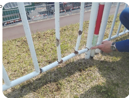
手摺の損傷を確認
