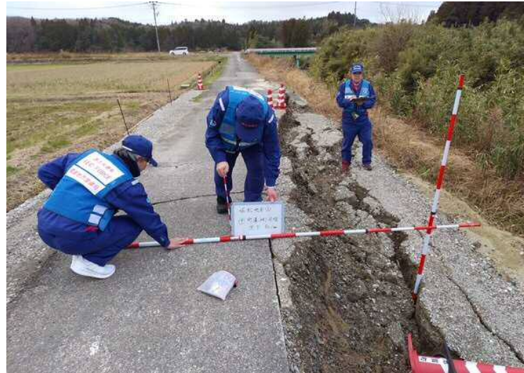
石川県志賀町の町道の被災状況調査
