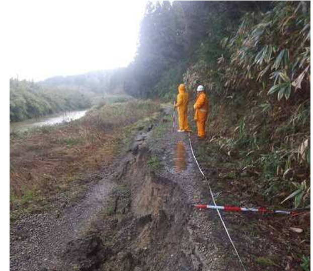
石川県志賀町の町道の被災状況調査
