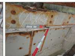
【補強鋼板の浮き・腐食】
