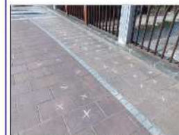
【橋面タイルの浮き】
