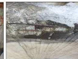
【アーチリブの剥離・鉄筋露出】
