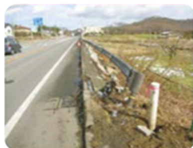
ガードレール・ 標識等の損傷
