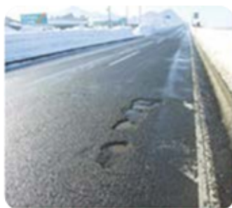
路面の穴ぼこ・ 段差
