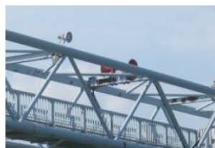
河川敷放送設備より放送
