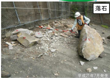
ロックシェッドへの落石状況
