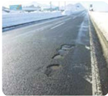
路面の穴ぼこ・段差
