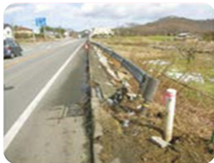
ガードレール・ 標識等の損傷
