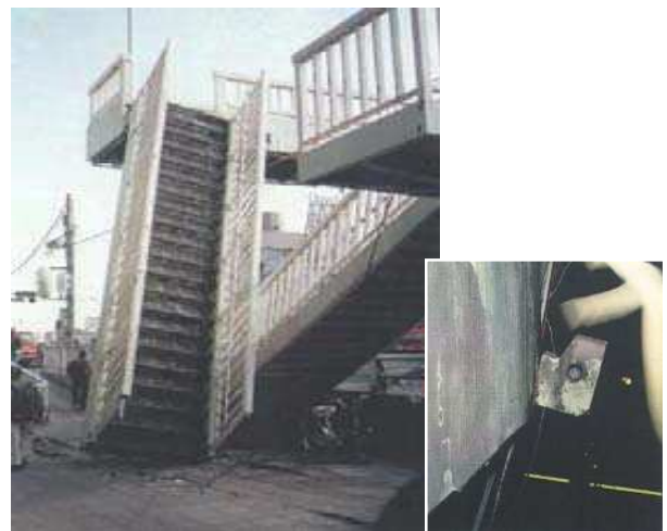
図-7 階段桁の脱落・落下、階段フックの破断
