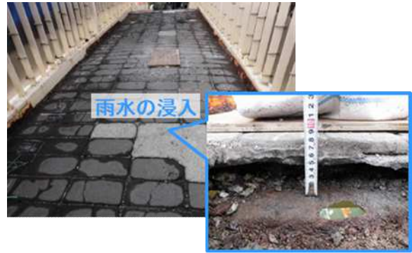
図-5 床版内部のコンクリート土砂化
