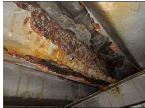
図-6 広範囲に腐食した床版
