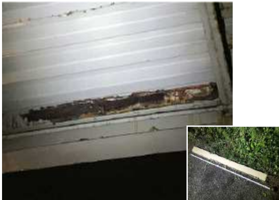
図-3 床版の補修跡と落下した補修部材
