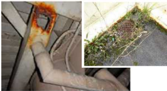
図-4 土砂の堆積と排水施設の損傷状況
