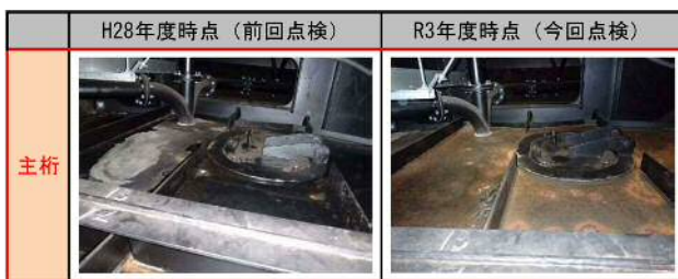
図-2 主桁の損傷状況対比図
