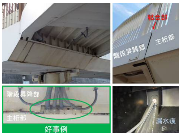
図-4 ロードヒーティング配管開口部の状況
