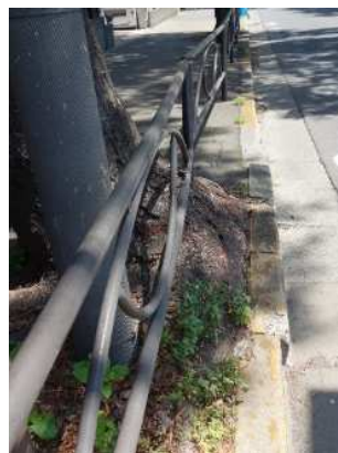
(写真-3 縁石損傷)
