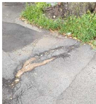
(写真-5 街路樹の根上)
