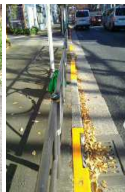
(写真-6 落ち葉による排水障害)
