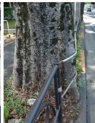
(写真-4 防護柵損傷)
