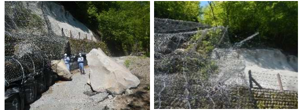
写真-7 落石状況及びカーテンネット破損状況
