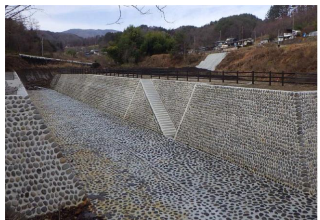
図-2 耐酸処理された護岸
