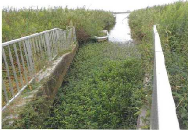
樋管前を塞ぎ、用排水に支障
