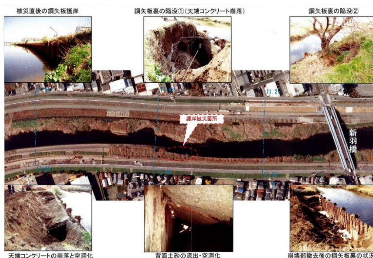
図 3-7 鶴見川大倉山地区の矢板護岸の老朽化状況
