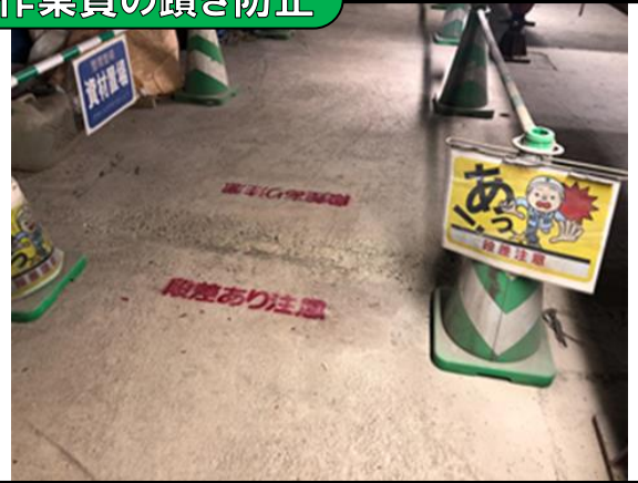
段差部に注意喚起表示
