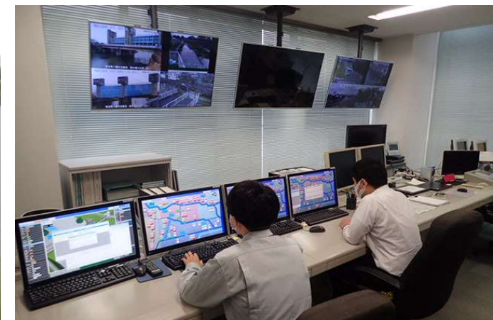
水門等の施設の遠隔操作
