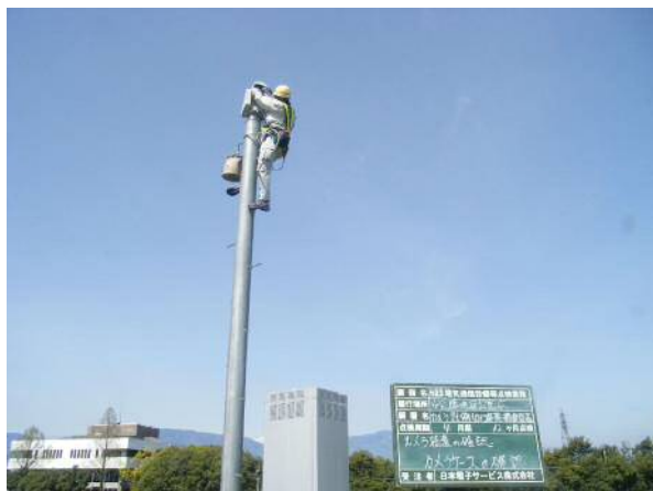
写真 6-5 CCTV カメラ（河川管理用カメラ点検）
