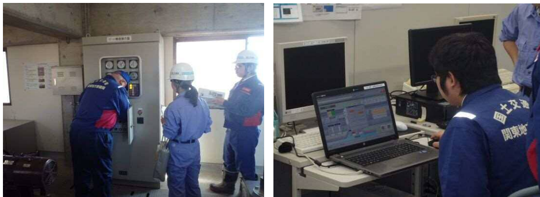
写真 3-14 樋門の操作訓練状況
