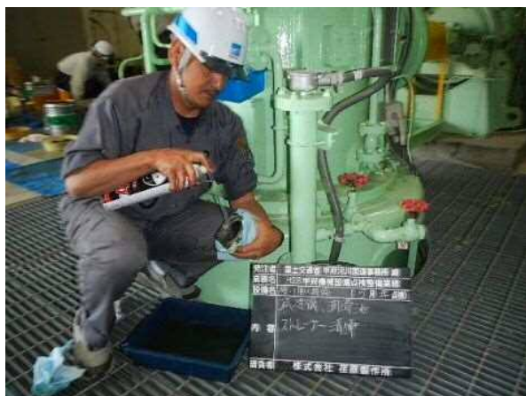
写真 5-9 排水機場点検（排水ポンプ点検）
