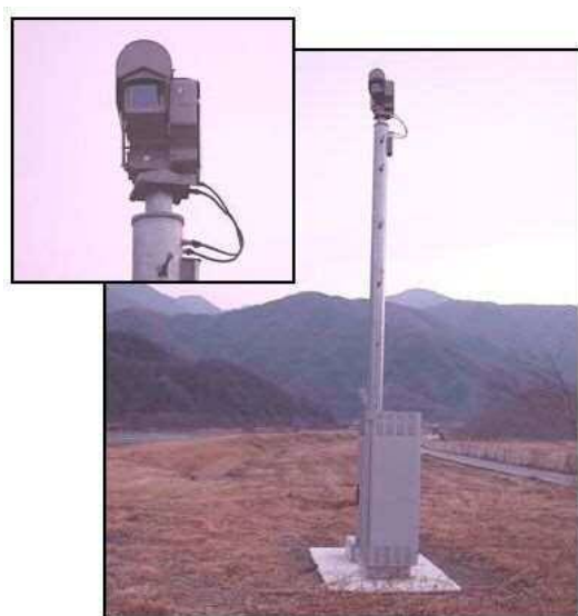
写真 3-9 CCTV カメラ（河川管理用カメラ）
