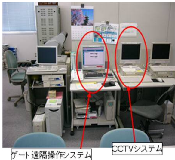
写真 3-6 ゲート遠隔操作システム
