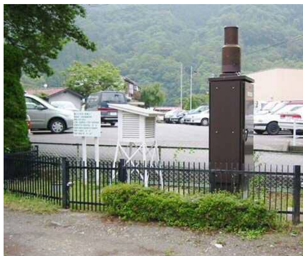
写真 3-10 雨量テレメータ設備
