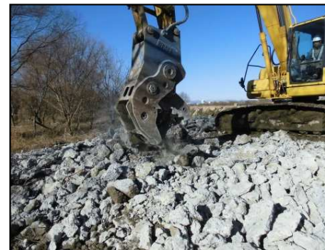
根固めブロック(2t)破碎状況
