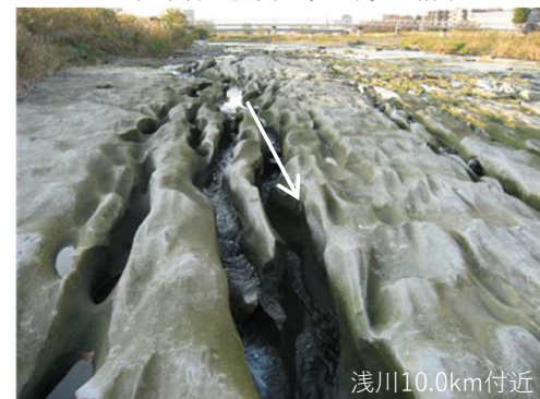
砂礫層が流出し、土丹が露出
