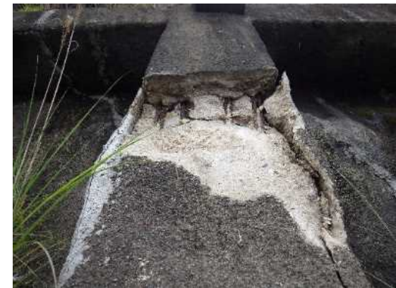
法枠工の老朽化損傷
