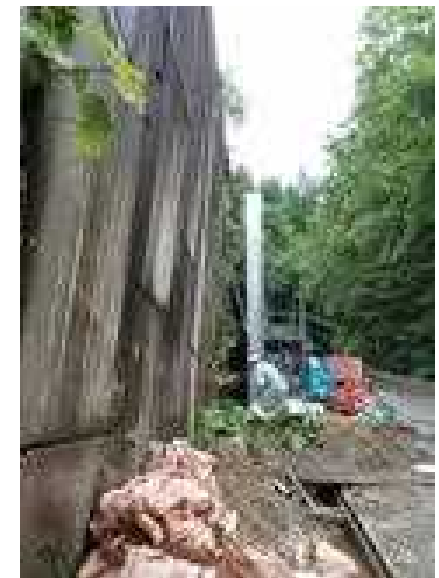
写真 壁面の傾斜の例
