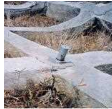
写真 受圧構造物の破損の例
