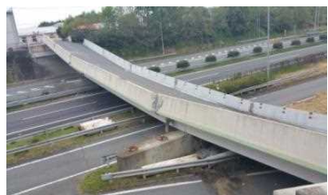
ロッキング橋脚を有する橋の落橋
