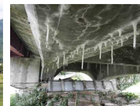
主桁のひびわれ
