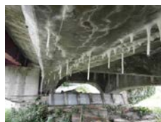
主桁のひびわれ
