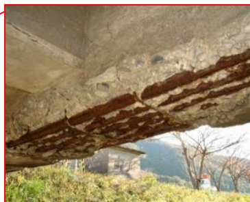
主桁の剥離、鉄筋露出
