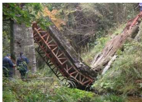
写真1 老朽化が原因で落橋した国内事例
