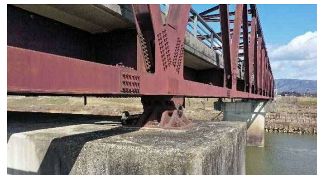
P2支承（固定）：ピンの脱落
