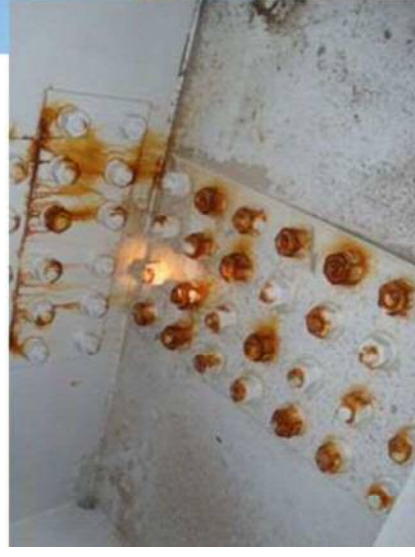
箱桁内のボルト部の腐食
