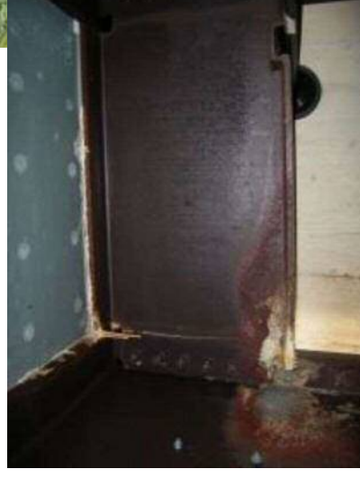
床版からの遊離石灰の析出
