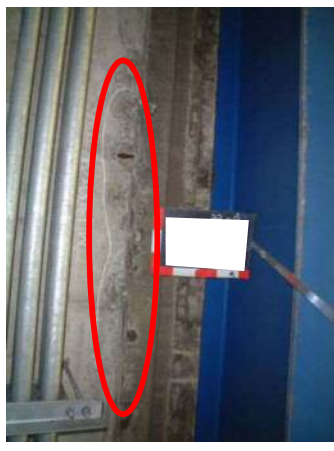
主桁の剥離・鉄筋露出
