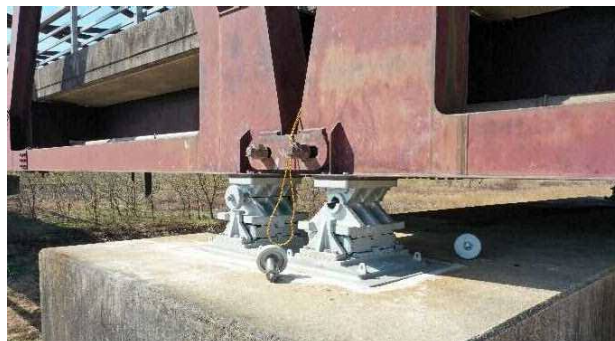
P3支承（可動）：ピンの脱落
