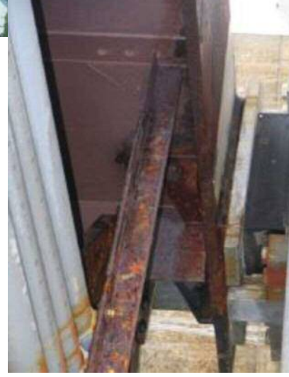
橋面排水の影響による腐食
