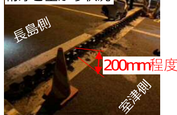
桁浮き上がり状況
