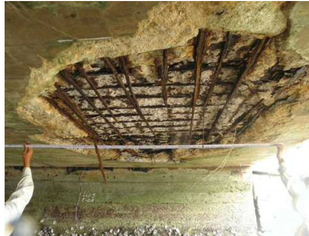
地方自治体管理 床版鉄筋露出
