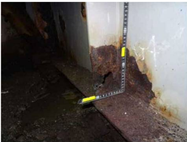
国管理 主桁腐食・欠損
