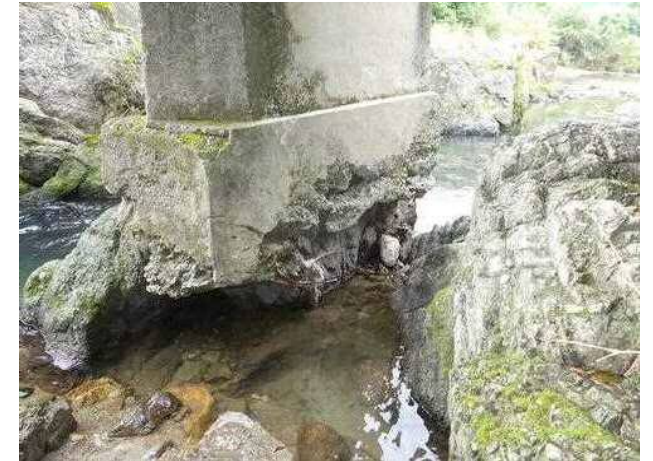
地方自治体管理 橋脚洗掘
