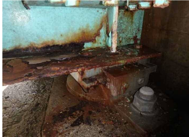
地方自治体管理 主桁腐食
