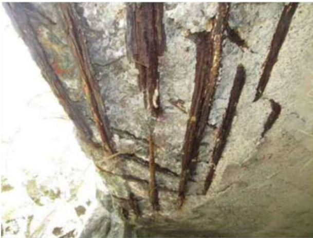
国管理 床版鉄筋露出 ※床版: 橋の裏側
