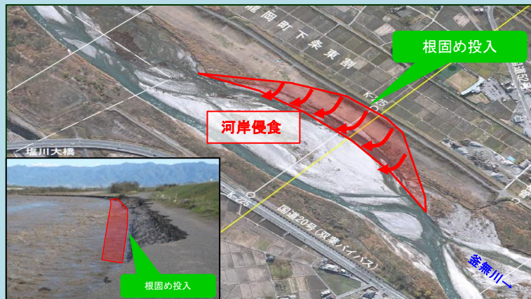
河岸浸食状況
