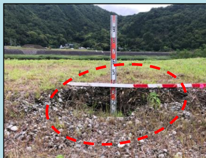
堤防・護岸の点検状況(陥没)
