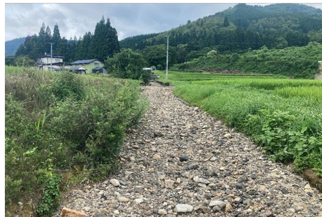
被災状況調査（寺泉地先）
