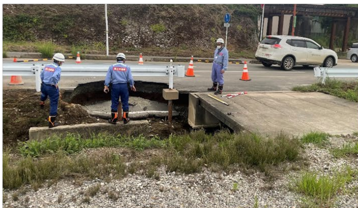
被災状況調査（成田地先）
