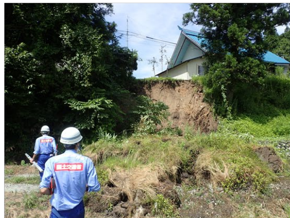
被災状況調査（芦沢地先）
