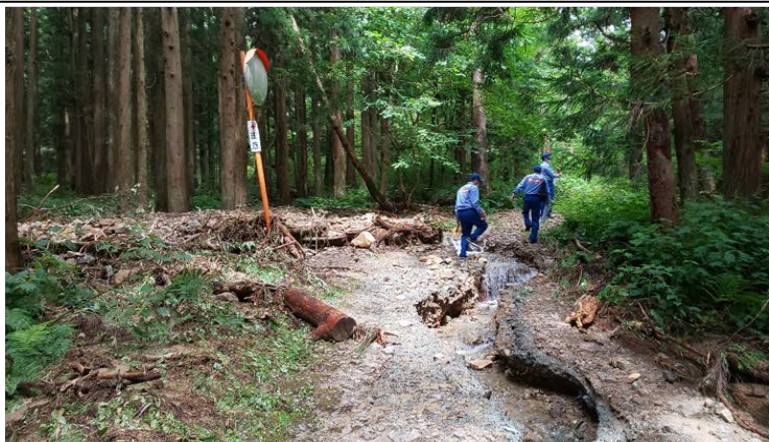
被災状況調査（川原沢地先）
