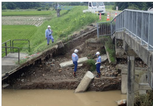
被災状況調査（泉地先）
