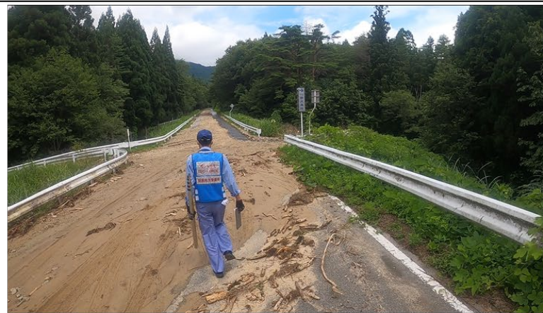
被災状況調査（川原沢地先）
