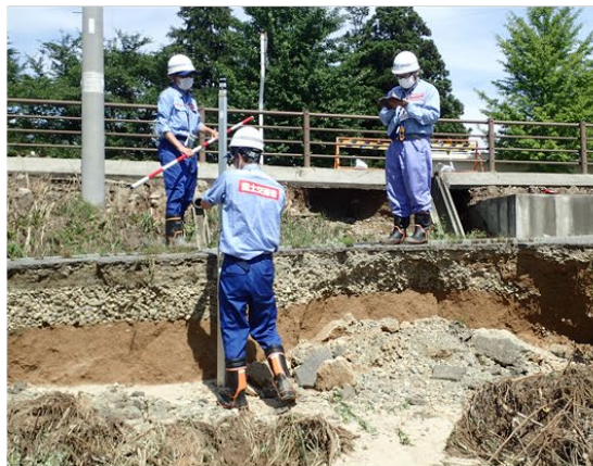
被災状況調査（歌丸(1)地先）
