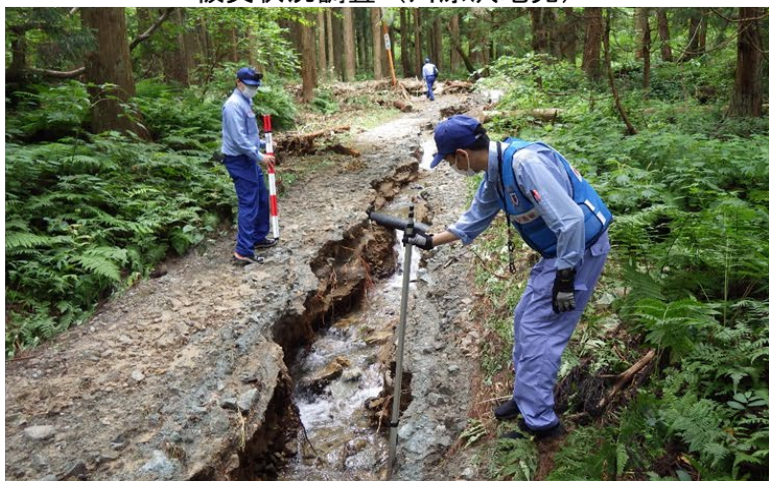
被災状況調査（川原沢地先）
