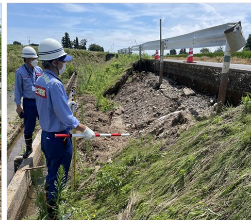
被災状況調査（歌丸(2)地先）
